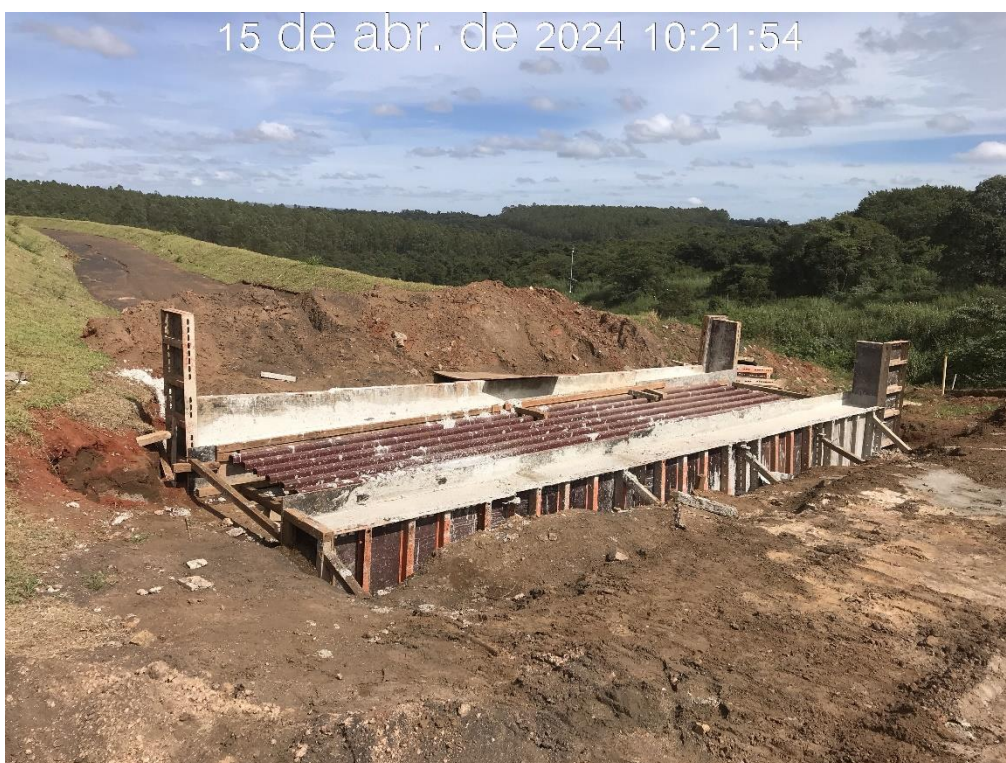
Figura 7.42 – Instalação da travessia “mata-burro” na elevação 952,50 m do canal de drenagem superficial da ombreira direita (15/04/2024).
