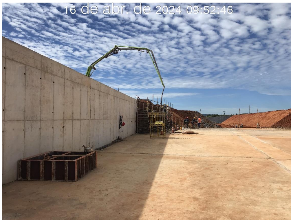
Figura 7.26 – Concretagem da parede do lado direito da transição 01 do canal rápido, com vista para montante (16/04/2024).
