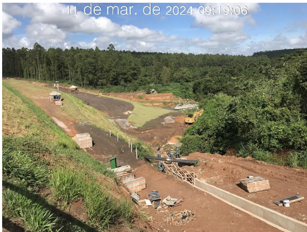
Figura 7.37 – Concretagem do módulo 10 e 11 do canal de drenagem superficial da ombreira direita, com vista para jusante (11/03/2024).
