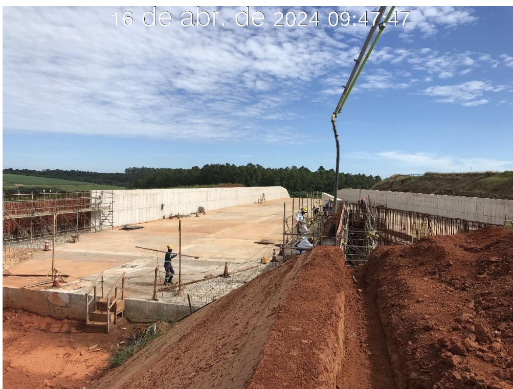
Figura 7.25 – Concretagem da parede do lado direito da transição 01 do canal rápido, com vista para jusante (16/04/2024).
