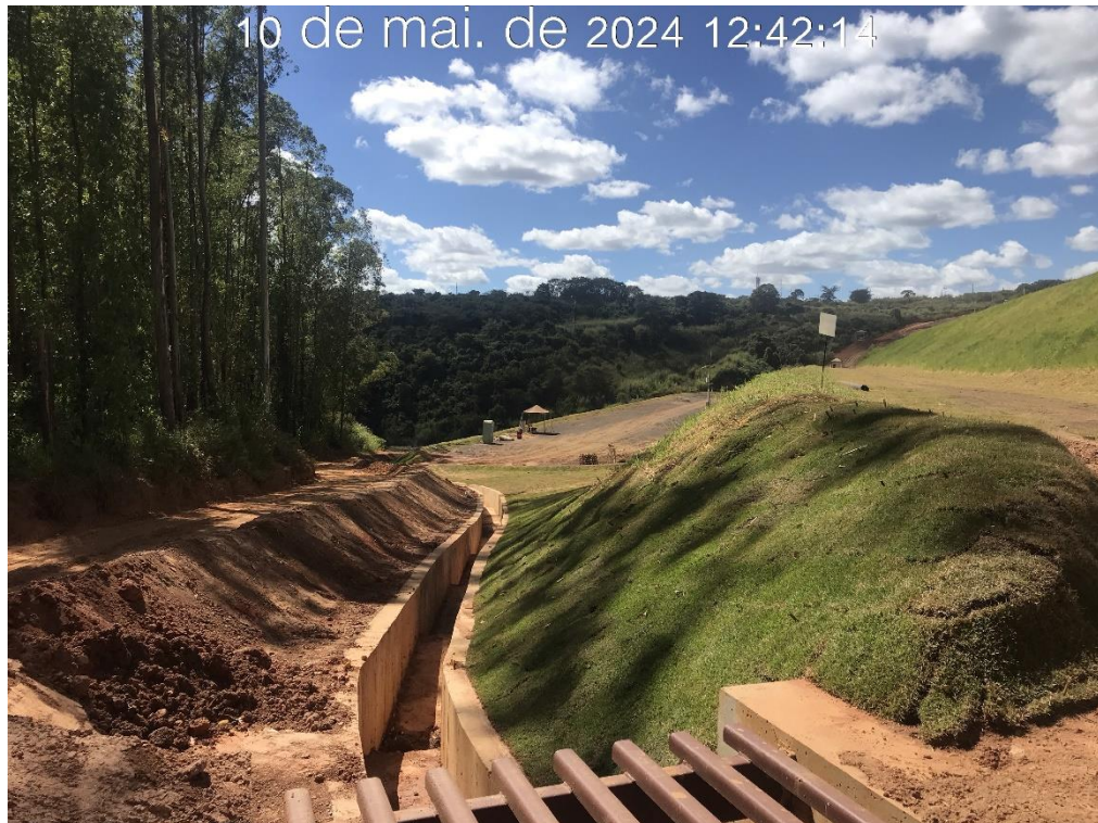
Figura 7.45 – Plantio de grama em placa, realizado nos taludes do canal de drenagem superficial da ombreira esquerda, com vista para jusante (10/05/2024).
