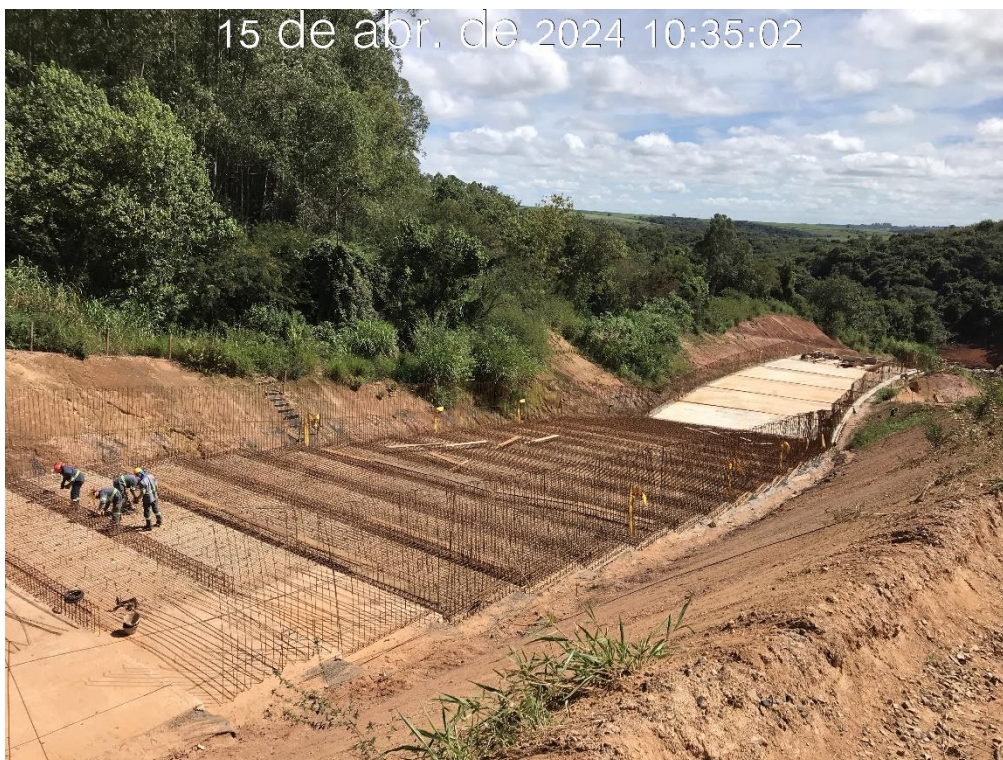
Figura 7.24 – Montagem da armação entre os módulos 26 e 30 do canal rápido, com vista para jusante (15/04/2024).
