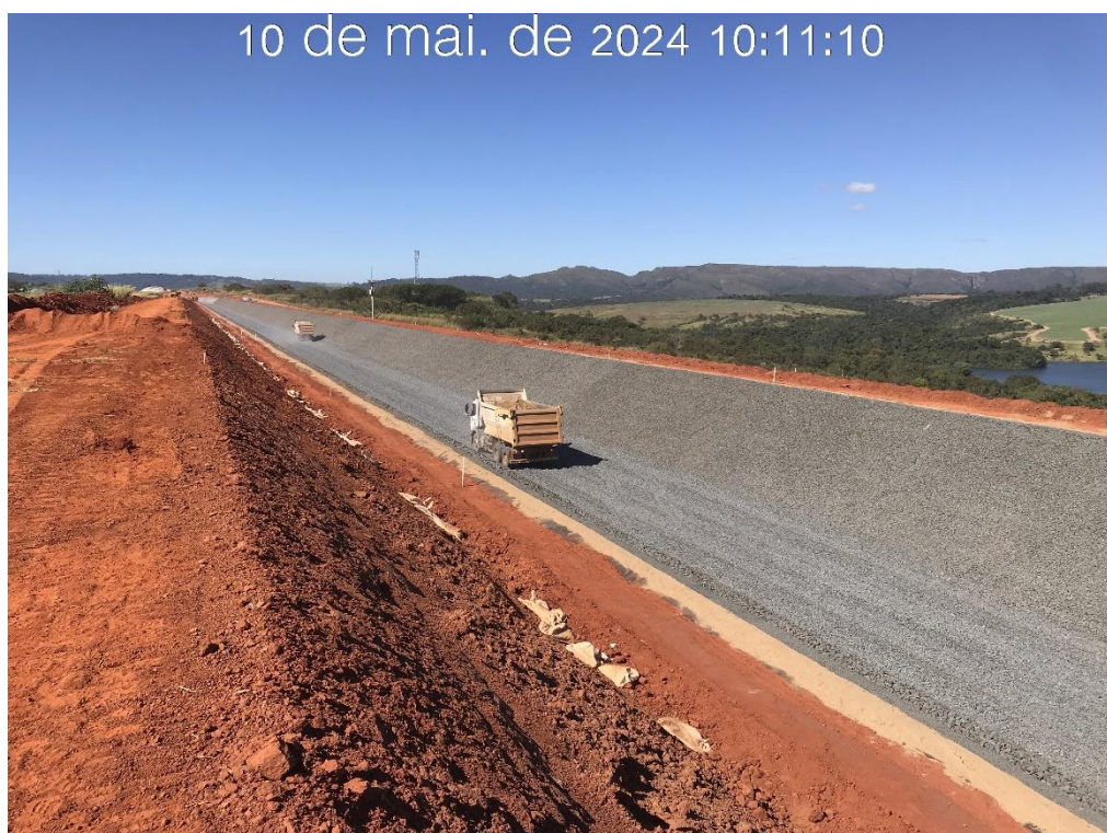
Figura 7.22 – Vista para montante do canal periférico, após o término da aplicação das transições 1 (areia), 2 (brita 0) e 3 (brita 3) entre as estacas 135 e 170 (10/05/2024).
