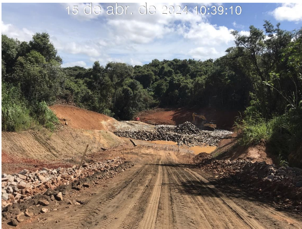
Figura 7.32 – Aplicação da camada de proteção (enrocamento) na bacia de dissipação do canal rápido (15/04/2024).
