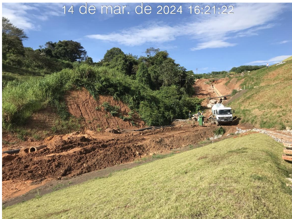
Figura 7.40 – Concretagem do módulo 11 do canal de drenagem superficial da ombreira direita, com vista para montante (14/03/2024).
