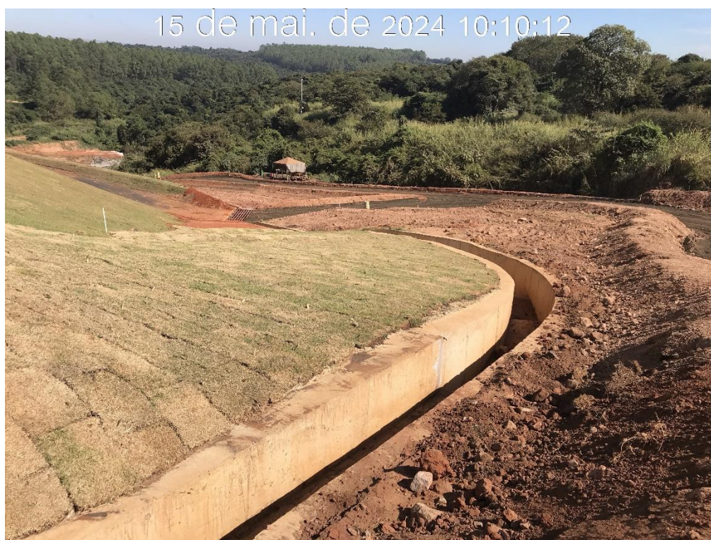
Figura 7.47 – Vista para jusante do canal de drenagem superficial da ombreira direita, com detalhe do plantio de grama em placa realizado nos taludes da lateral esquerda (15/05/2024).
