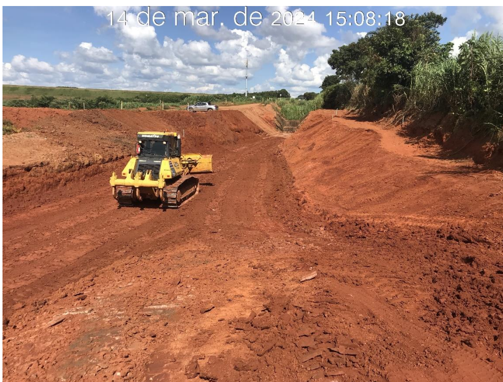
Figura 7.3 – Escavação na transição entre o canal existente e o canal periférico, na região da estaca 22 com vista para montante (14/03/2024).
