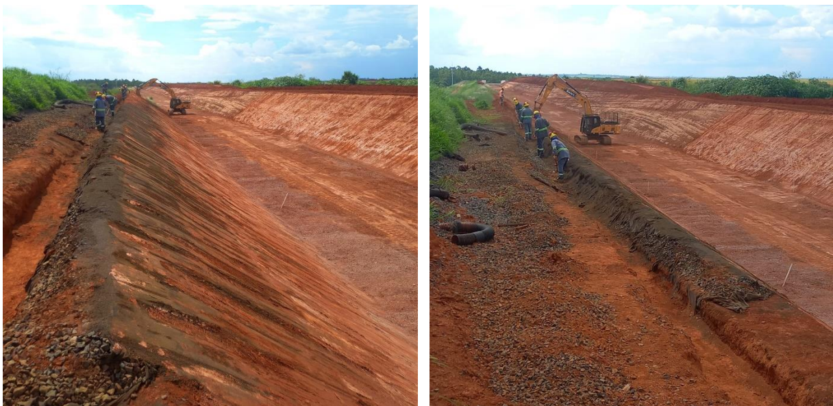
Figura 53 – Regularização de fundo e paredes para recebimento da geomembrana e execução de valas de ancoragem – estaca 137.
