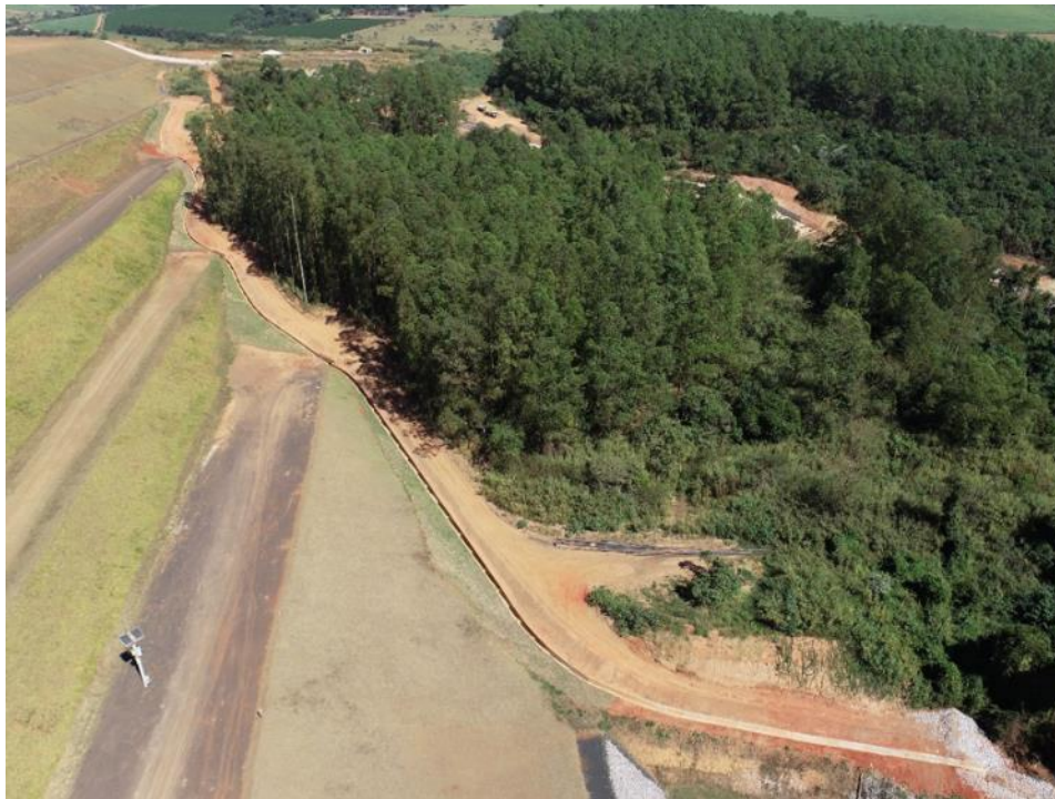
Figura 117 – Vista geral da finalização da implantação do canal de drenagem – ombreira esquerda
