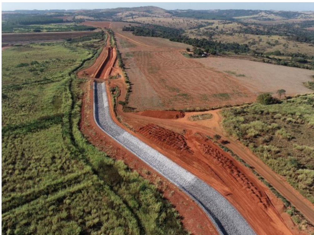
Figura 78 – Avanço da transição (areia, brita 0 e brita 3) e enrocamento no canal periférico.
