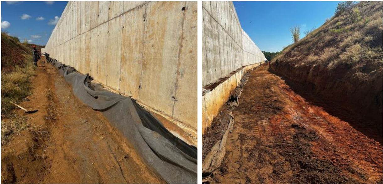
Figura 55 – Limpeza para encontro de dreno de fundo com dreno lateral ao canal rápido
