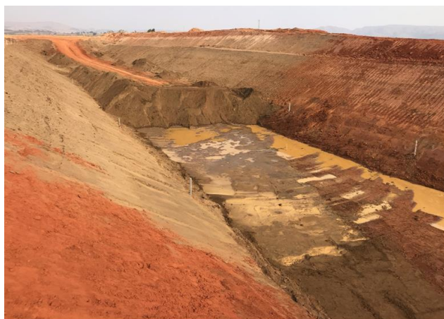
Figura 31 – Surgência de água durante escavação do canal do reservatório
