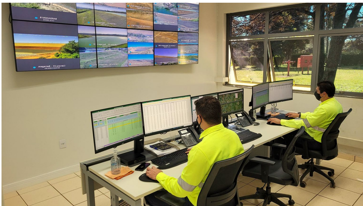
Figura 8-1 - CMI - Centro de Monitoramento Integrado em Tapira – MG.
